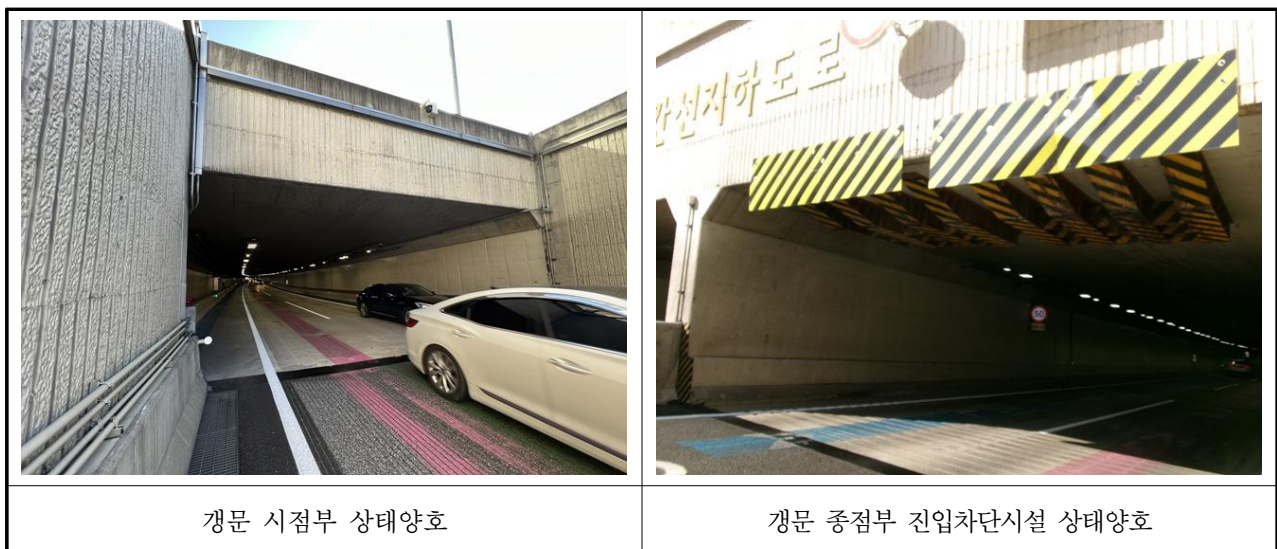
【사진 3.3.16】 갯문 손상현황
