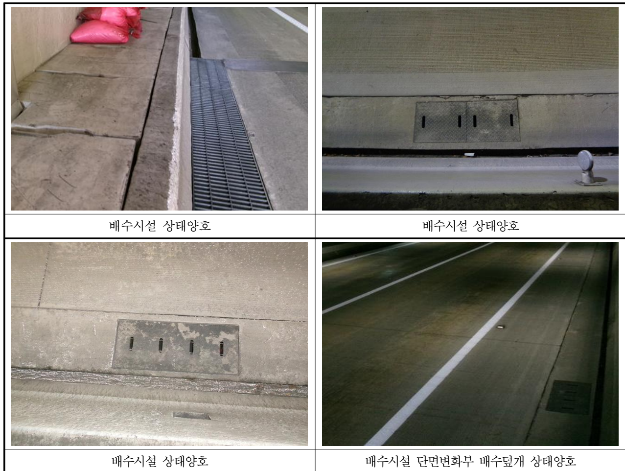
【사진 3.3.30】 배수시설 손상현황
