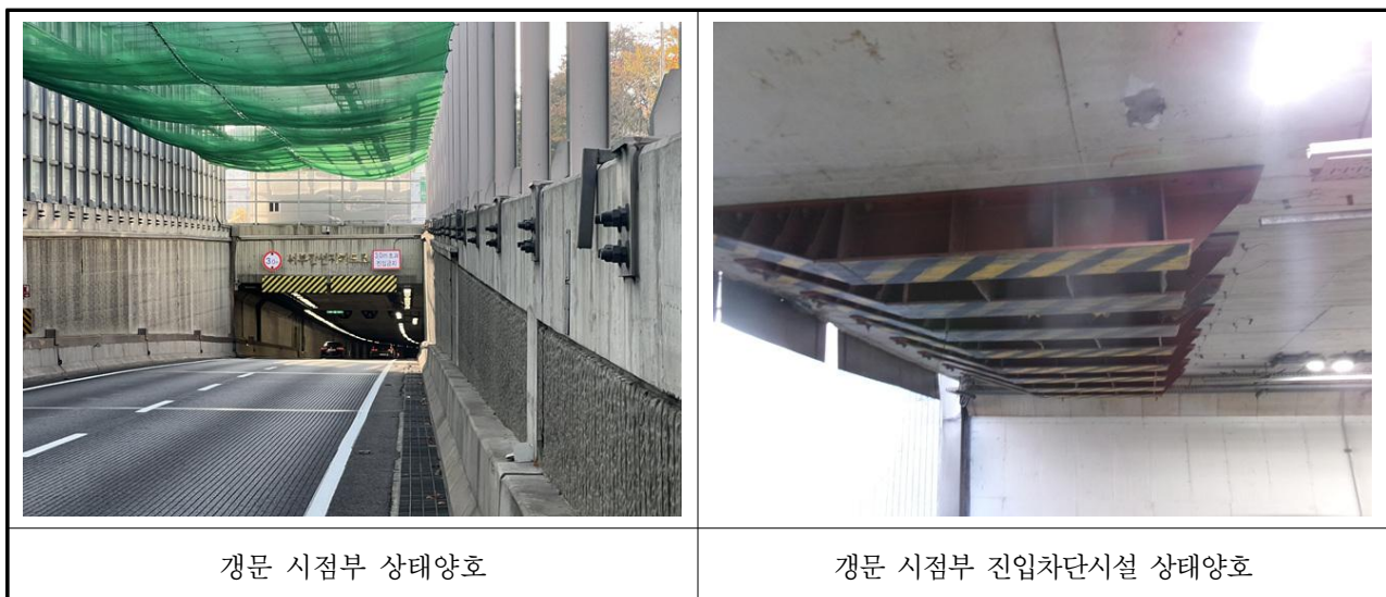
【사진 3.3.32】 갯문 손상현황
