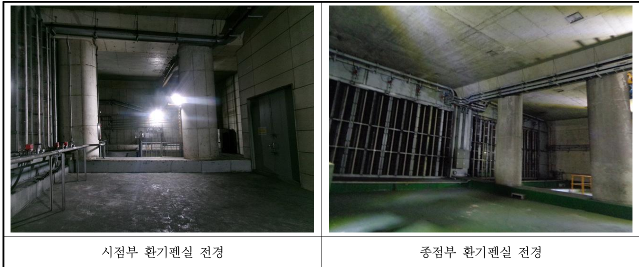
【사진 3.3.37】 환기시설 전경
